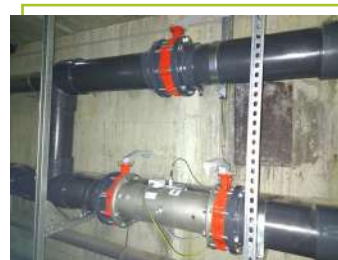
Un des canons UV mis en place à la piscine pour un nouveau traitement des chloramines de l'eau des bains par ce procédé
