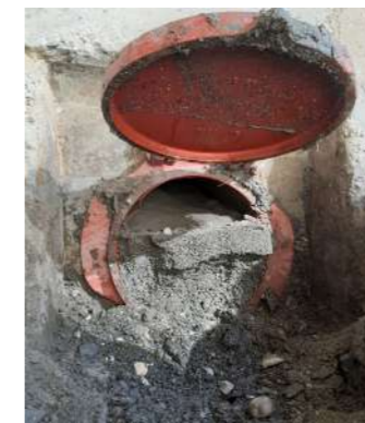
Bypass du poste de relevage obstrué
